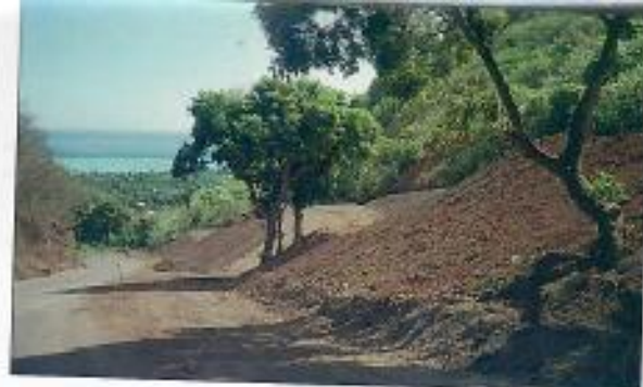
Terrassement pour la construction des lotissements : la multiplication des lotissements, construits sans aucune précaution, est principalement responsable. Le problème est surtout préoccupant à Tahiti, entre la Pointe Vénus et la vallée de l'Orofero.
