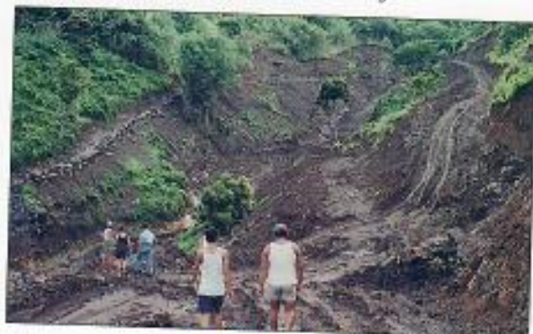
Terrassements pour la construction des routes : la technique de terrassement qui consiste à mettre en déblais le long de la route, au fur et à mesure de l'avancement des travaux est particulièrement nuisible.
