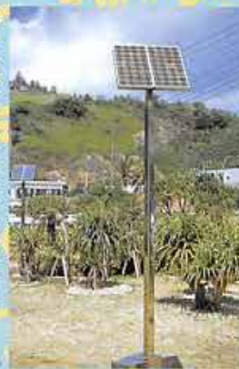
二見港付近は夜間照明用電源にソーラー発電を使う。
