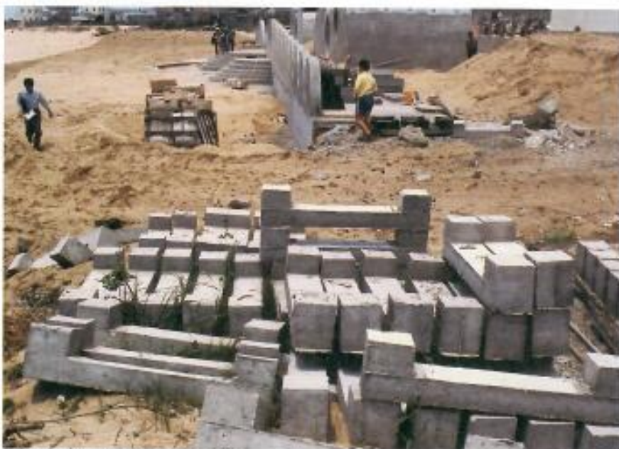
沙灘上進行人工建物，破壞生態環境。
